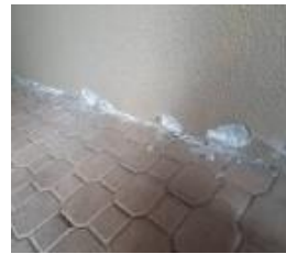
ピロティ部の欠損
