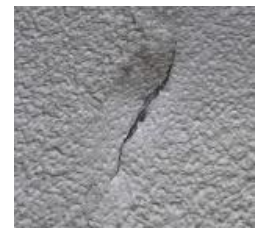
コンクリート部のクラック
